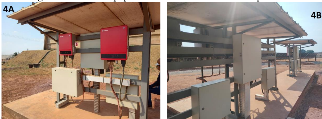
Figuras 4A e 4B – Equipamentos elétricos associados aos painéis solares.
